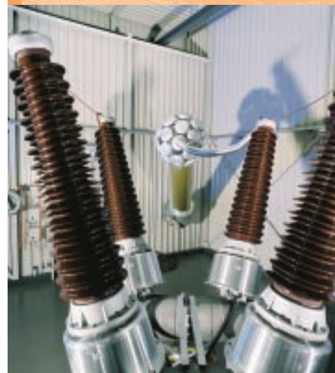
Заводские испытания высоким напряжением
